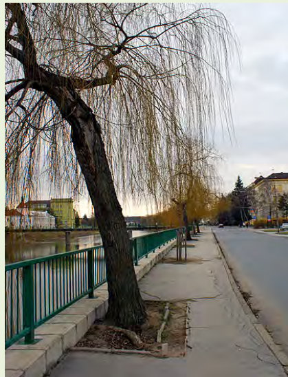
Poškodený a nedostatočný koreňový systém (malý prekoreniteľný priestor) v dôsledku zadláždenia, veľké poškodenie hornej časti kmeňa vŕby bielej; hrozí odlomenie koruny Zdroj: http://www.treeworker.cz/
